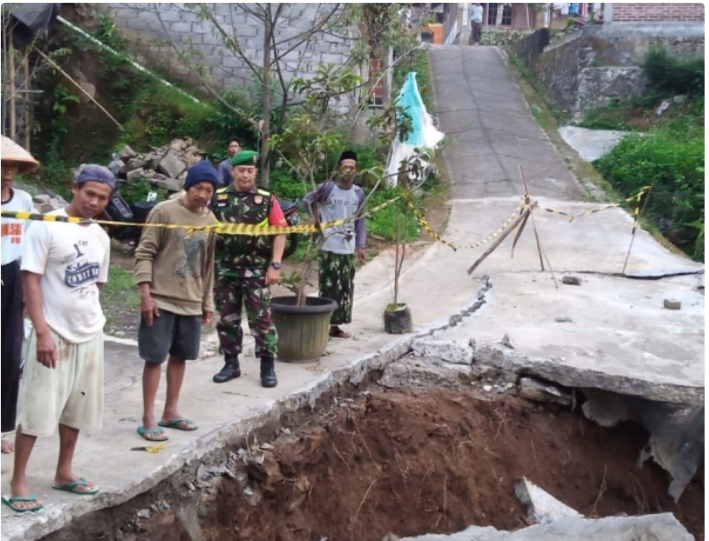
Peltu Cahyo Nugroho saat melihat kondisi jembatan yang terkena tanah longsor.
